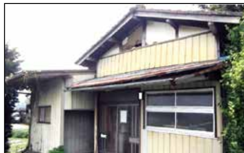
▲老朽危険空き家として市で除去した建物
