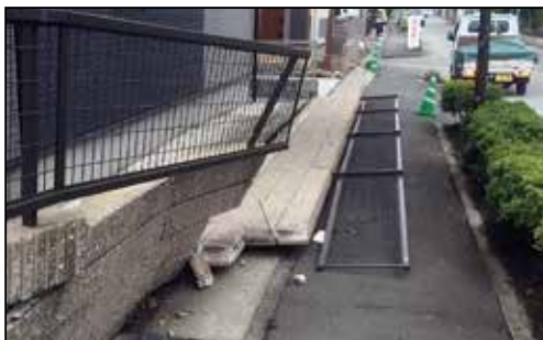
▲ブロック塀の倒壊例
