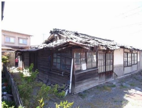
市内の老朽化した危険な空き家のイメージ
