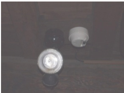
写真 4-4 センサーライト + 自動火災報知機
