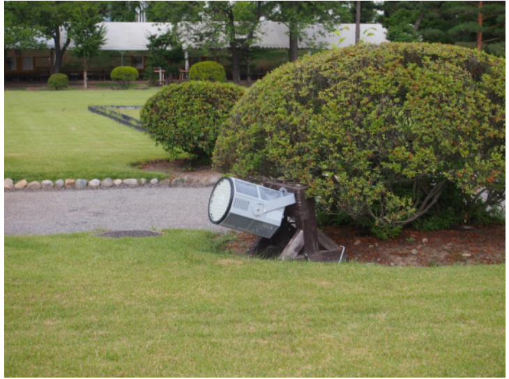
写真 3-14 ライト（LED）設置状況
