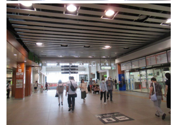
松本駅東西自由通路の天井部に設置した スプリンクラー
