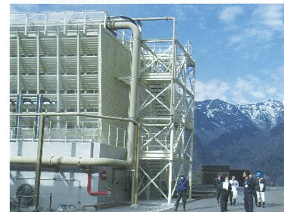
— 地熱発電所の外観の一部 —
