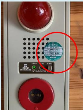
非常警報設備 (点検記録を確認)
