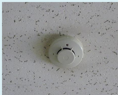
自動火災報知設備 感知器
