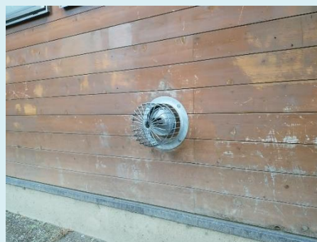
FF暖房機の排気口
