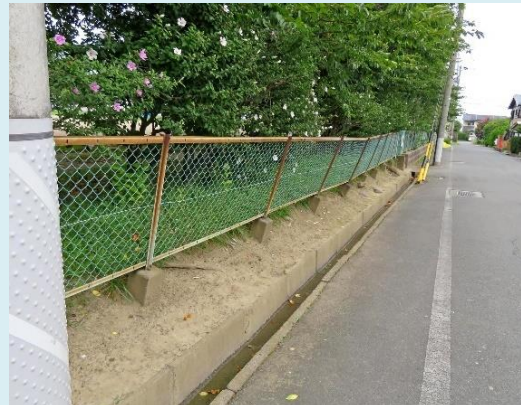
ネットフェンスが傾斜しています
