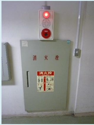
屋内消火栓設備 ホース箱
