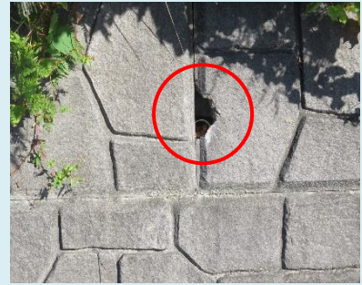
擁壁水抜きパイプが損傷しています
