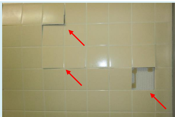
内壁のタイルが剥離している
