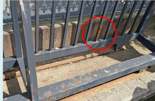
鉄製門扉の錆による劣化
