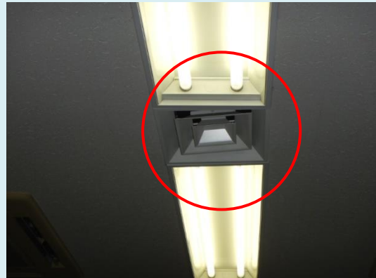
吹き出し口 器具の曲がり
