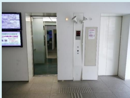
エレベーター
