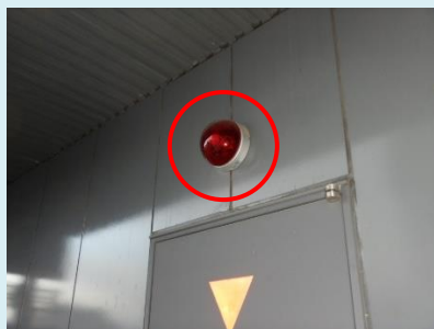
非常用進入口の赤色灯が 点灯していません
