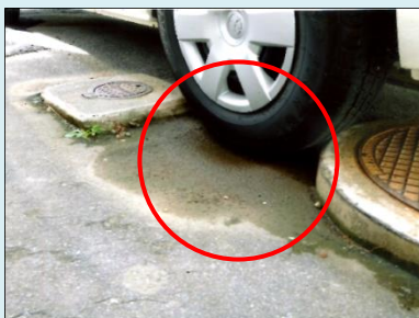
アスファルト舗装が陥没し、 つまづき易くなっています
