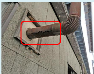
腐食が進行すると落下の危険があります
