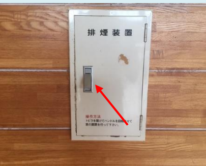
排煙装置ボックスを開けて 作動を確認してみましょう
