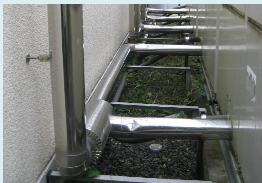
屋外機の配管が潰れています
