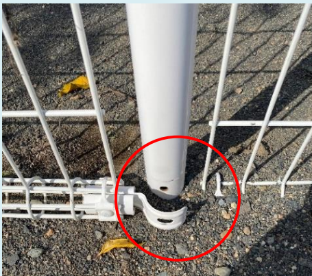
フェンスの金具外れている場合があります 専用のボルトナットで固定しましょう
