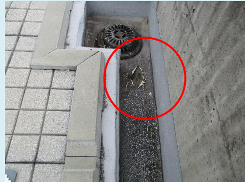
排水溝の露出防水が破断しています
