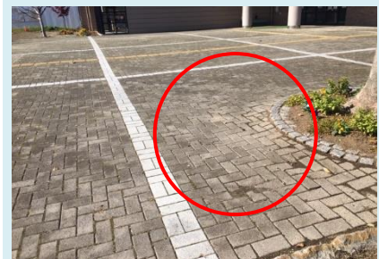
インターロッキング舗装の不陸 が見られます
