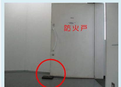
防火区画の常時閉鎖扉 くさびによる閉鎖障害
