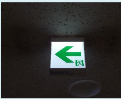
通路誘導灯 避難口の方向を示す誘導灯
