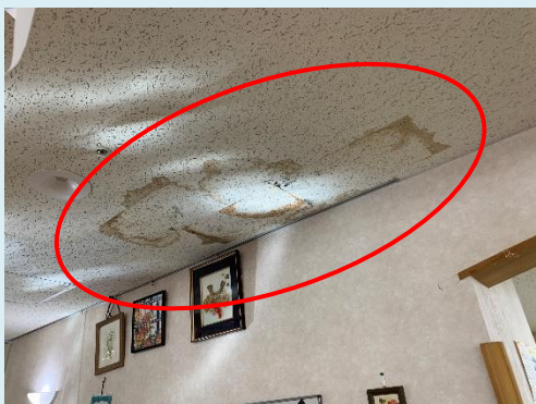
天井材雨漏り跡
