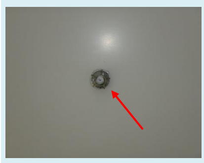
天井面スプリンクラーヘッド
