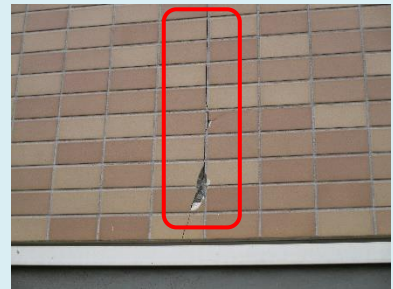
外壁サイディングのクラック
