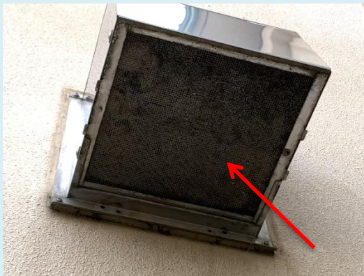
換気扇フードの網が目詰まりしています
