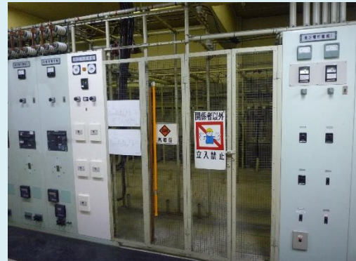
開放型変電所
