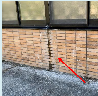
タイルの浮き サッシ廻りからの漏水もあります
