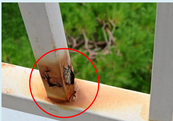
鉄骨の手摺に錆が見られます
