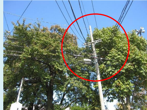
電線に樹木が接触しています
