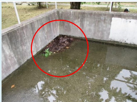
排水溝にゴミが詰まっています 泥上げ、清掃をしましょう
