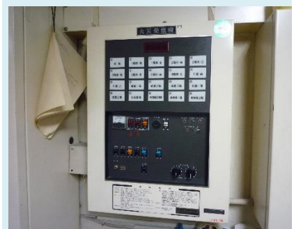
自動火災報知設備 受信機
