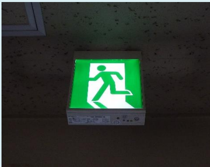
避難口誘導灯 避難口の位置を示す誘導灯
