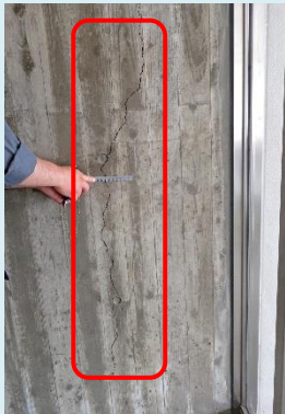
コンクリート壁のクラック
