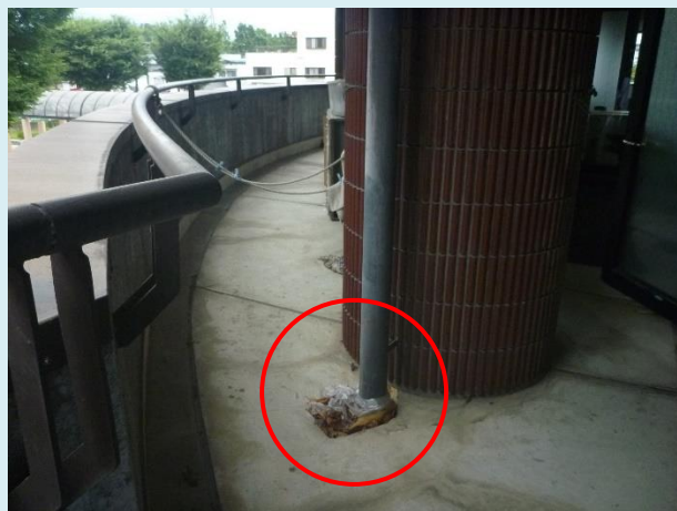
バルコニーの排水にゴミが詰まっています 泥上げ、清掃をしましょう
