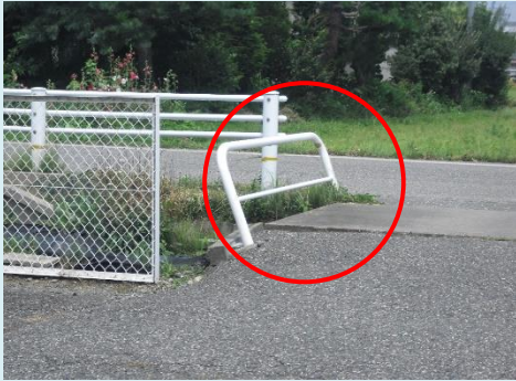
ガードレールが傾斜しています
