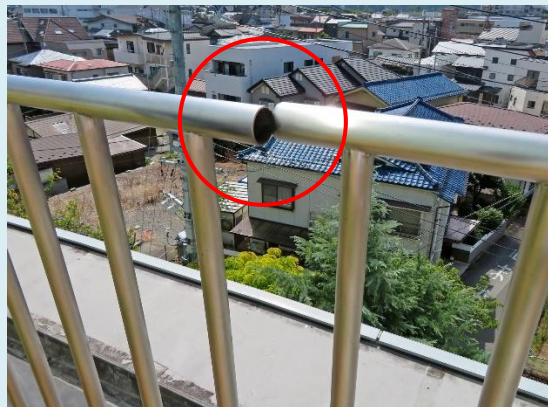
手摺のジョイントが破断しています
