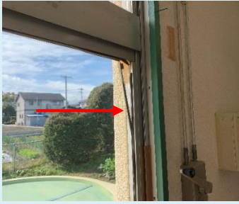
ガラスを留める成形ゴムが 損傷しています
