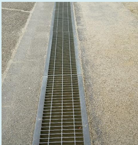
U型側溝・グレーチング
