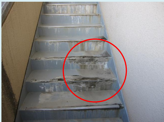
屋外階段の防水仕上げ材が劣化しています 歩行に支障があると避難の障害にもなります
