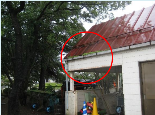
樋が落ち葉で詰まって、鉄部が錆びています 清掃が必要になります
