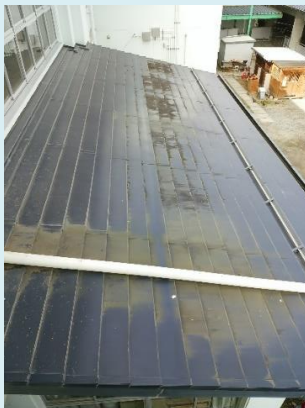
屋根に落ち葉や泥がたまっている場合、 雨漏れの原因になります
