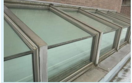
トップライトのシーリングの劣 化は雨漏れの原因になります
