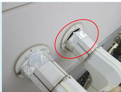
空調室外機配管カバーに隙間があります
