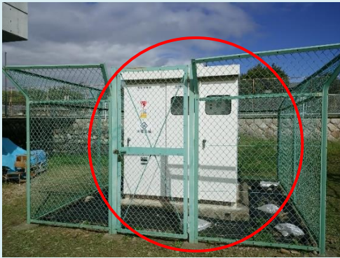
屋外キュービクル
