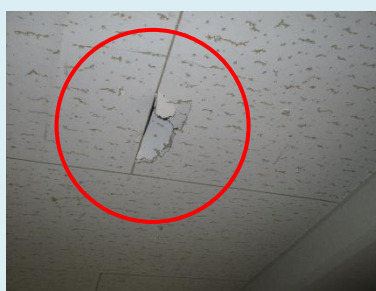
天井材の一部破損
