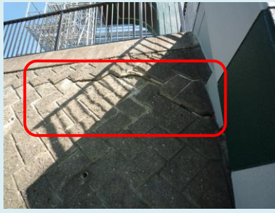
間地積みブロック擁壁のズレがあります
