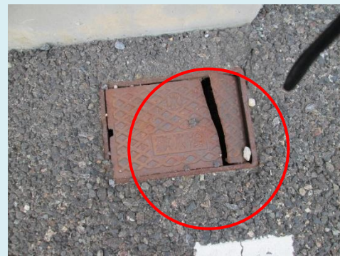
散水栓の蓋が割れています
