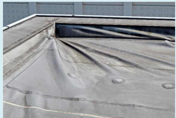
露出シート防水層が膨れています
