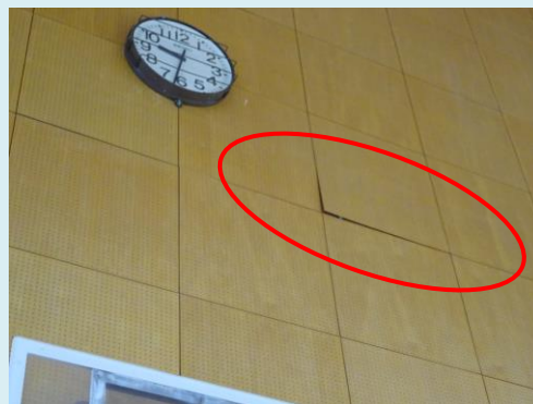
内壁の有孔ベニアに破損がある
