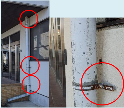
縦樋のつかみ金物が損傷して外れています
