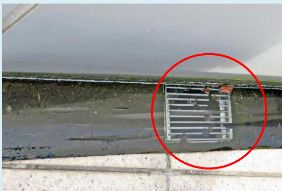
排水口が詰まっています
