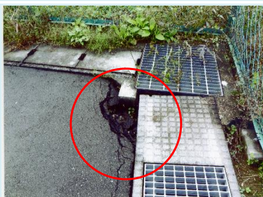
側溝付近が陥没しています
