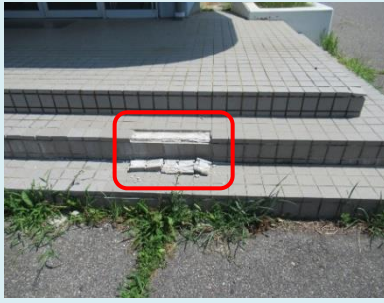
タイルが剥離しています
