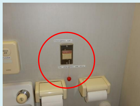
多目的トイレの呼出ボタン 正常に作動するか確認しましょう
