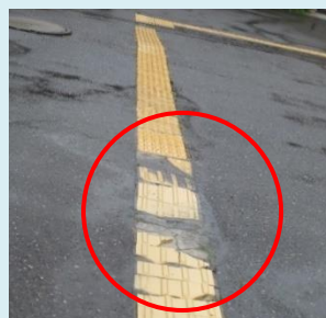
誘導ブロックの一部が破損し ています
