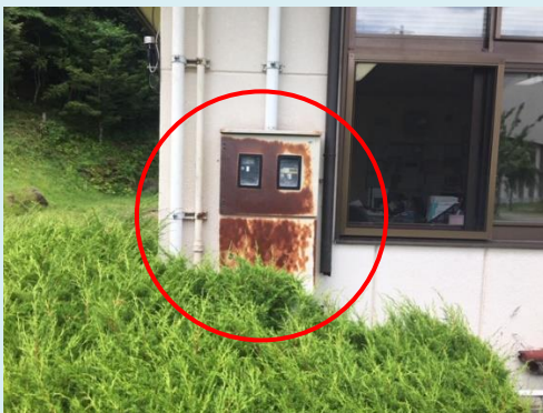
引込み計器盤
