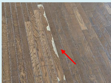
フローリング床材の劣化
