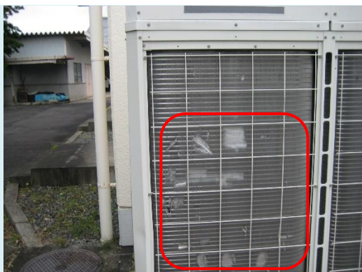
エアコン室外機フィンの破損
