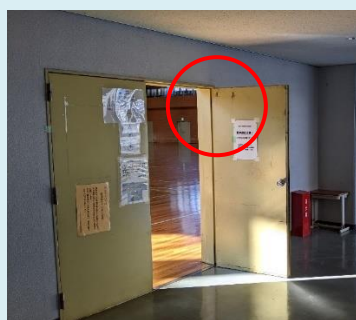
常時閉鎖防火戸を維持するための金具が外れています
