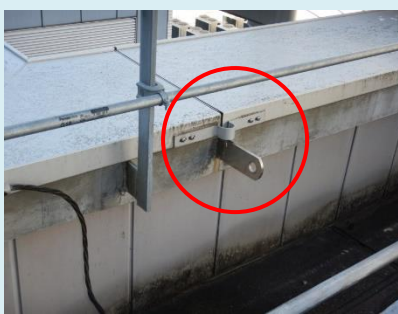
避雷針の棟上導体
