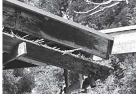
腐食が進む木製雨樋
