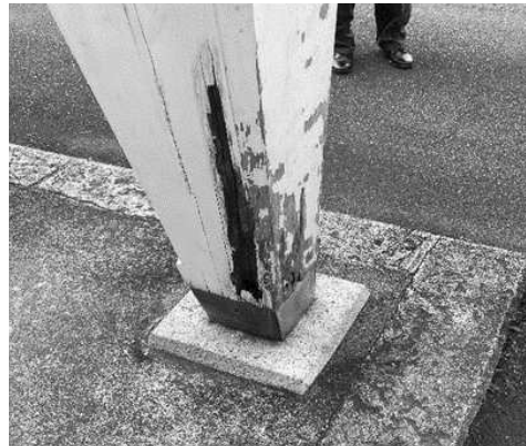
写真（腐食部分）
