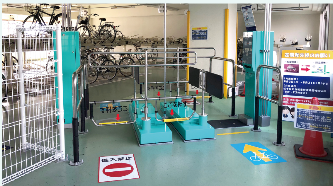
図 サイクルゲート（松本駅北自転車駐車場）
