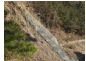
⑯ 治山施設
