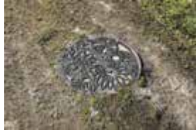
⑥ マンホール
