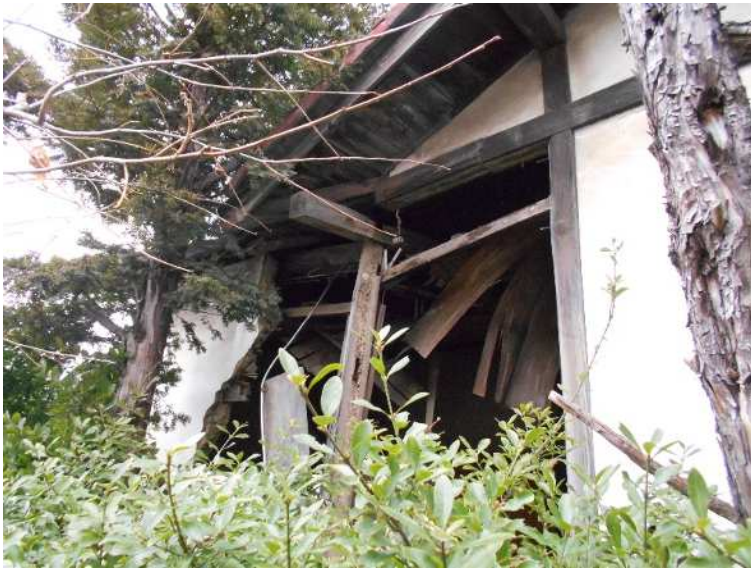
柱の破損、傾斜、屋根の破損
