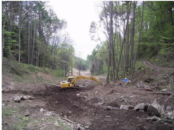
平成18年に岡谷市で発生した土石流被災地
