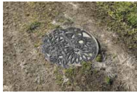
⑥ マンホール
