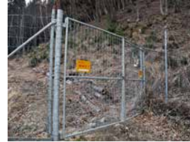
⑦ 鳥獣被害防止防護柵 ゲート
