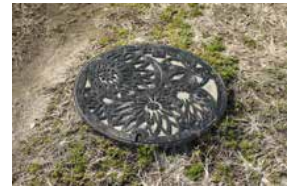
④ マンホール
