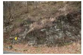
④ 落石防護施設
