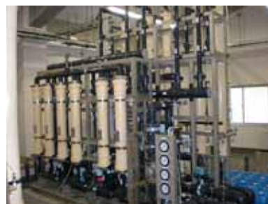
水上浄水場(膜ろ過)
