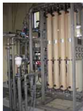
金松寺浄水場(膜ろ過)
