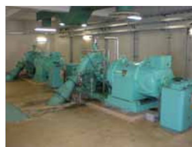
島内第2水源地(送水ポンプ)
