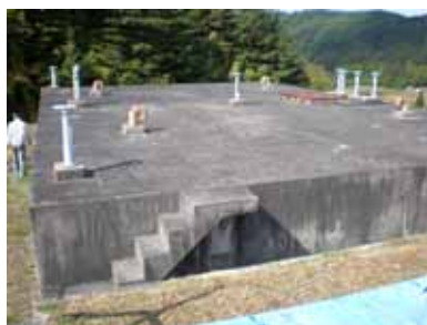
金山低区配水地
