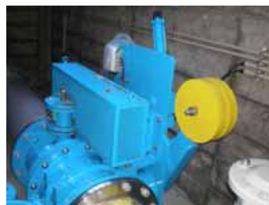
妙義配水地(緊急遮断弁)
