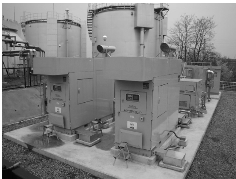
宮渚浄化センター 消化ガス発電設備
