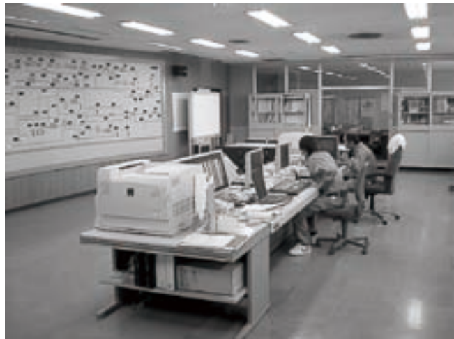
〈上下水道局中央監視制御システム〉
