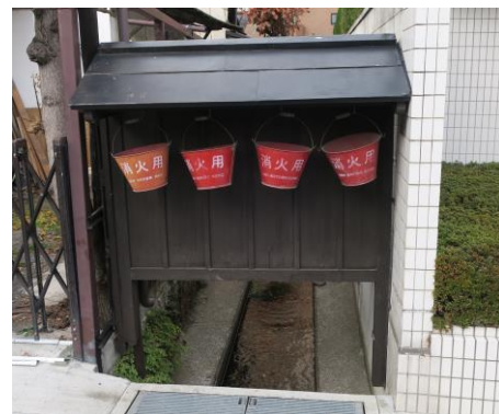
蛇川上に設けられた防火用バケツ
