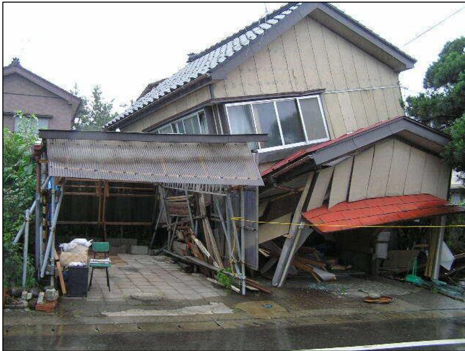
2007 年（平成 19 年）中越沖地震での新潟県柏崎市の家屋倒壊
