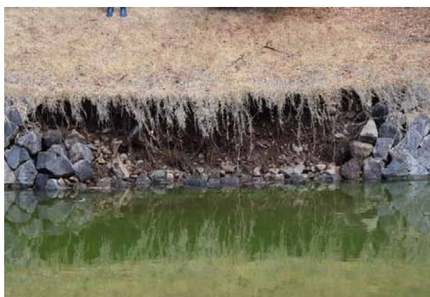
崩落した、旧博物館南側の石垣（令和6年3月）★
