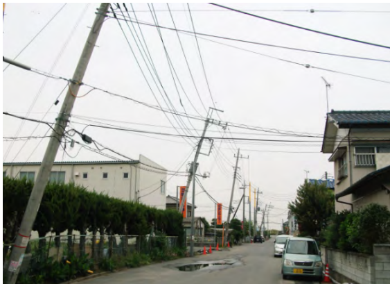
液状化による電柱の倒壊
