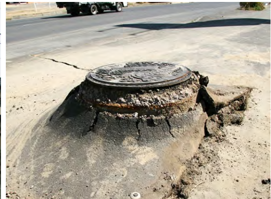
マンホールの浮上
