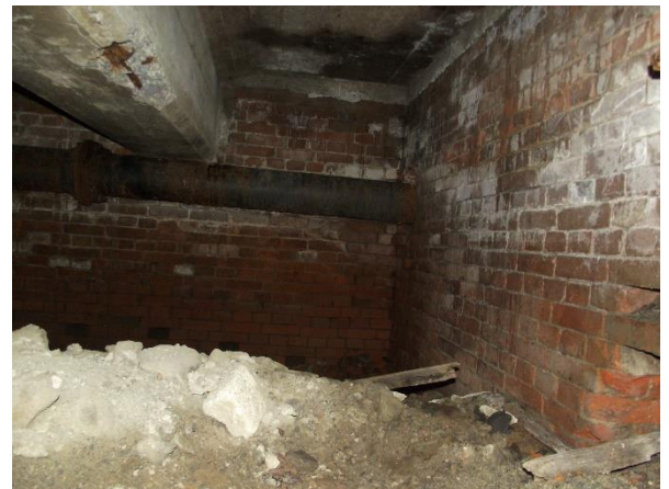
構造物を貫く配管
