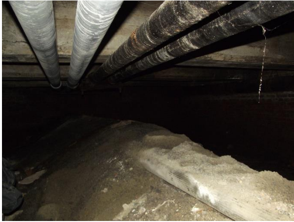
既存配管と堆積土
