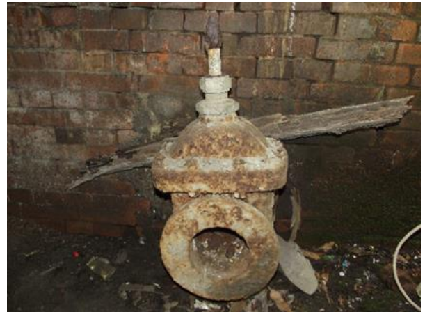
西側(駅方向)給水バルブ正面
