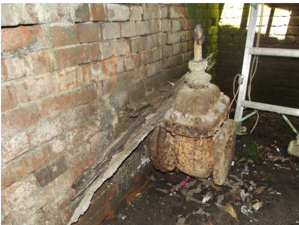
西側(駅方向)給水バルブ 横方向
