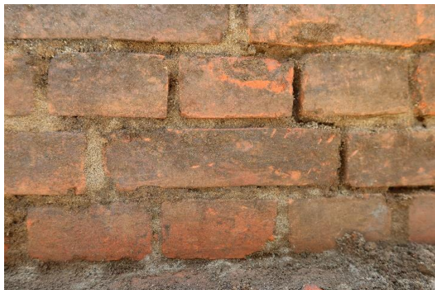
北壁レンガ目地 砂が多い
