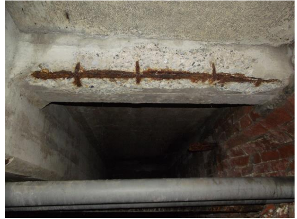
コンクリート構造物 劣化状況
